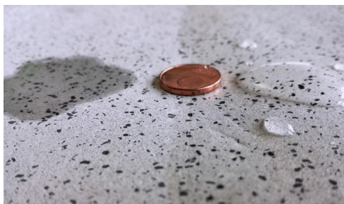
Links: ungeschützt - Wasser dringt ein
