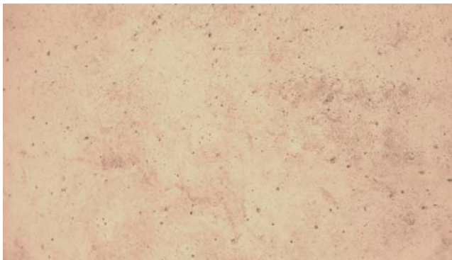
Glattgeschalter Sichtbeton der Rezeptur zum Vergleich. Standard fairfaced concrete of mix design to compare.
